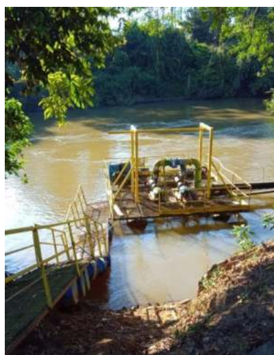
Figura 4. Monitoramento do nível da captação. Nível: 4,5 metros em 22/05/2024.
